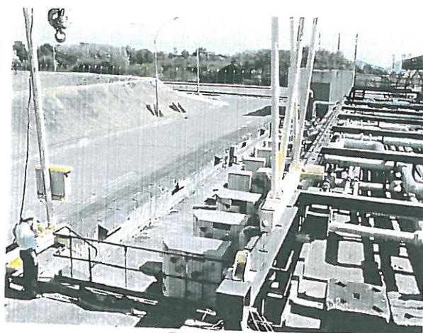
Photo n° 9 Station de gavage
