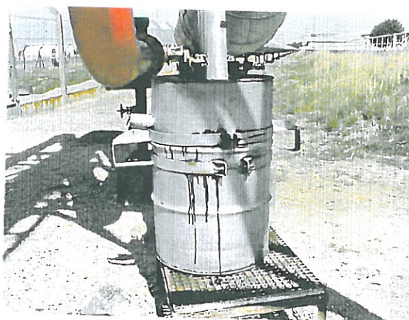
Photo n° 8 Fût de récupération des égouttures
