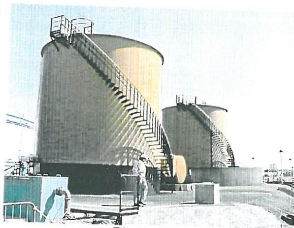
Photo n° 10 Réservoir de décantation
